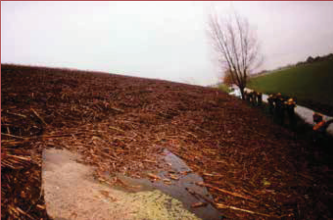
Riet gelegd zonder voldoende afschot met dakvilt als ondergrond: een rommeltje.
